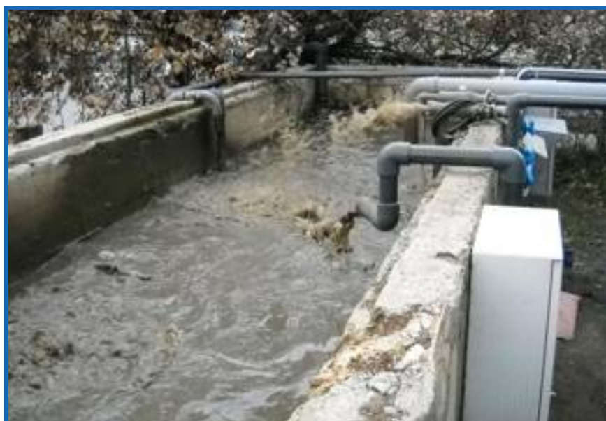
▲ Foto 1- Unità di denitrificazione
