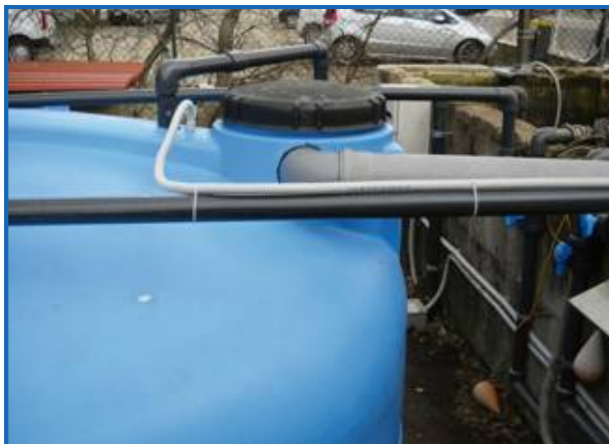
▲ Foto 4 - Serbatoio integrativo denitrificazione
